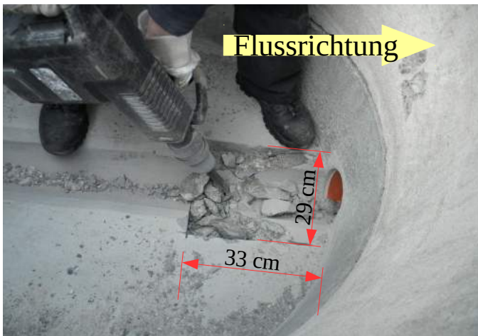
1. Ausbrechen des Oberbetons auf der Auslaufseite des Schachtgerinnes ca. L33 x B29 x T12cm
