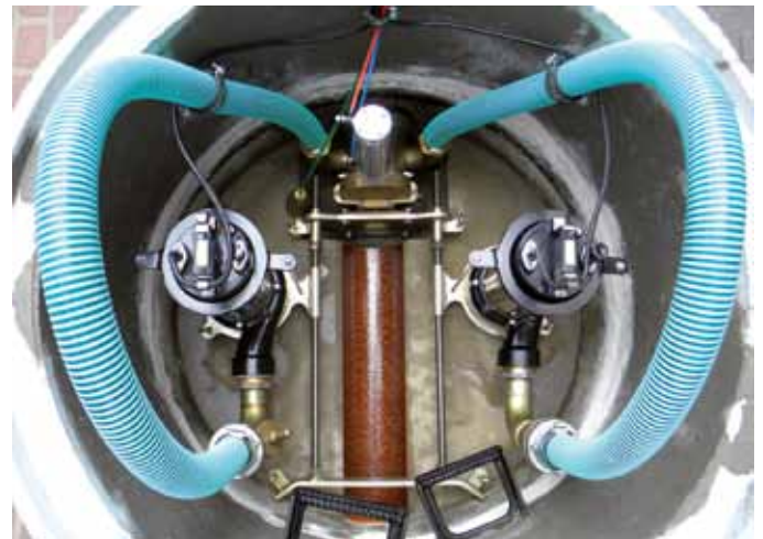
Doppelpumpensystem „RKS 800“ im Übergabeschacht.
