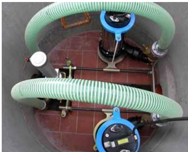
... mit den Druckleitungen verbunden.
